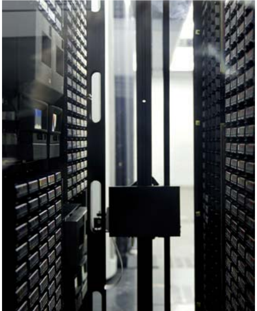
Bandroboter für Datensicherungen im besonders geschützten Brandabschnitt
